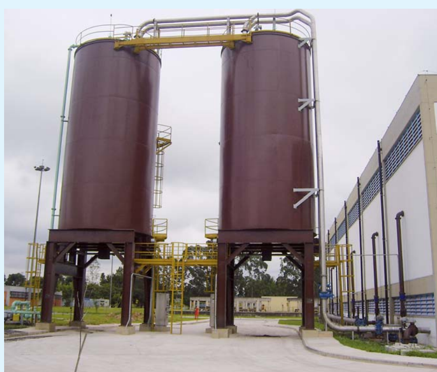
Silos derramaram o lodo no pátio
